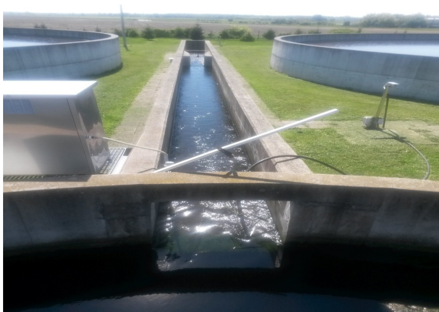
Slika 10. Ispust u Venturijev kanal UPOV „Jošine“
