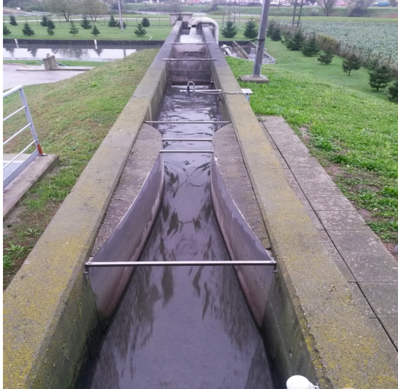
Slika 3. Ulazni Venturijev kanal UPOV „Jošine“
