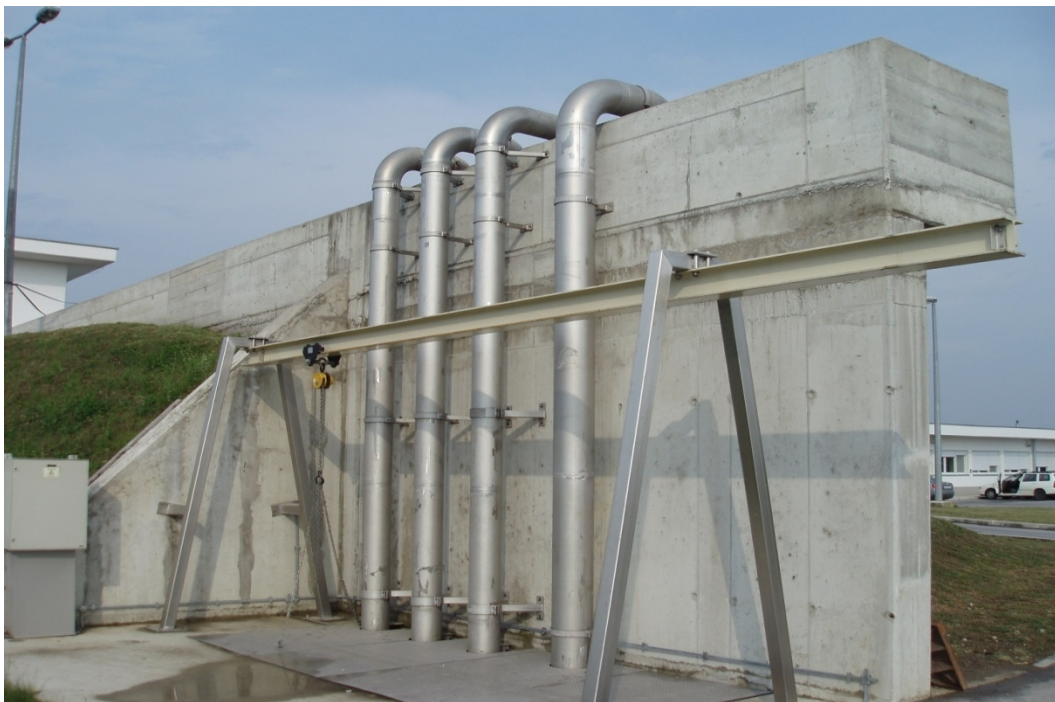
Slika 2. Ulazna crpna stanica UPOV „Jošine“
