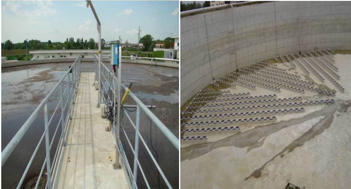
Slika 7. Aeracijski bazeni s puhalima UPOV „Jošine“
