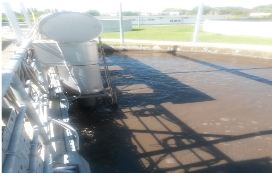
Slika 9. Crpna stanica za mulj UPOV „Jošine“
